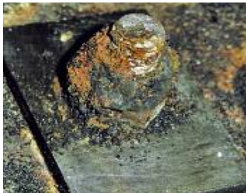
Figura 14: Corrosione galvanica su bulloni di acciaio inox in un bacino di filtraggio relativamente ad una installazione per il trattamento delle acque con impiego di carboni attivi: il bullone d'ancoraggio in acciaio inox 1.4016 (430) montato (a sinistra) e smontato (a destra) mostra la riduzione della sezione trasversale dovuta alla corrosione.
